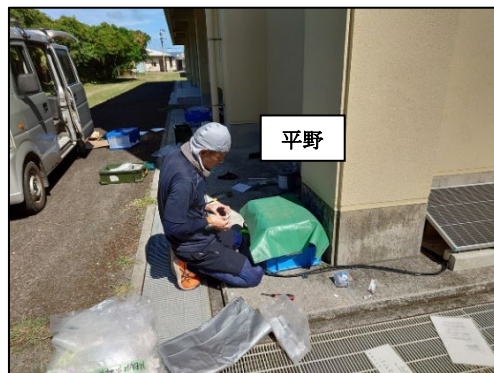
小宝島テレメータ観測点設置
