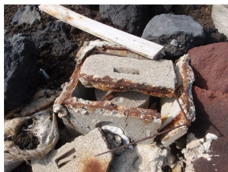
写真8 コンクリート製破損状況
