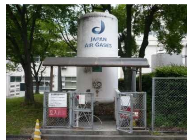
図3 液体窒素貯蔵タンク
