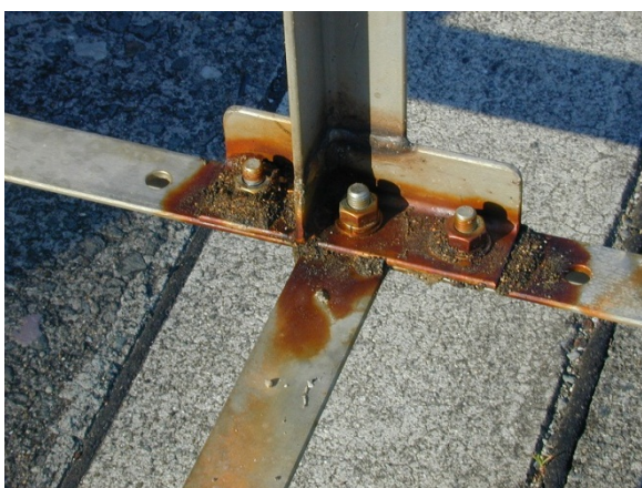
図-5 錆びたフレーム
