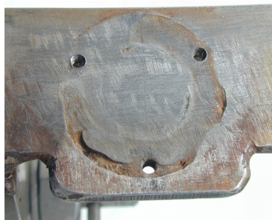
図-7 フレーム上部の水準器取付部の腐食
